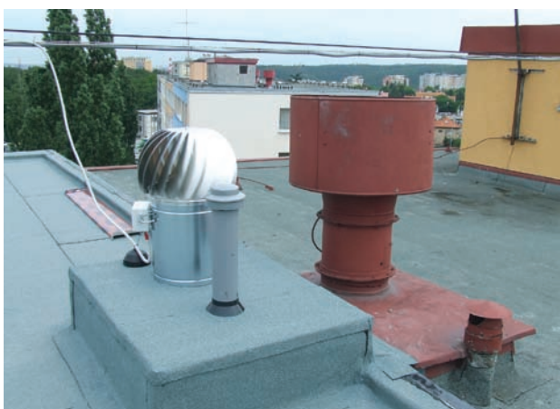
Hybridní ventilátor HV14 vlevo a původní ventilační turbína vpravo
